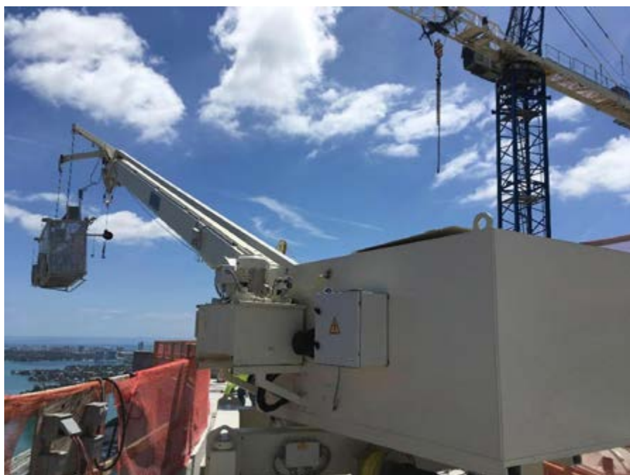
Plataforma BMU instalada por Pro-Bel en la torre residencial One Thousand Museum (Scorpion Tower), en Miami (Florida).
