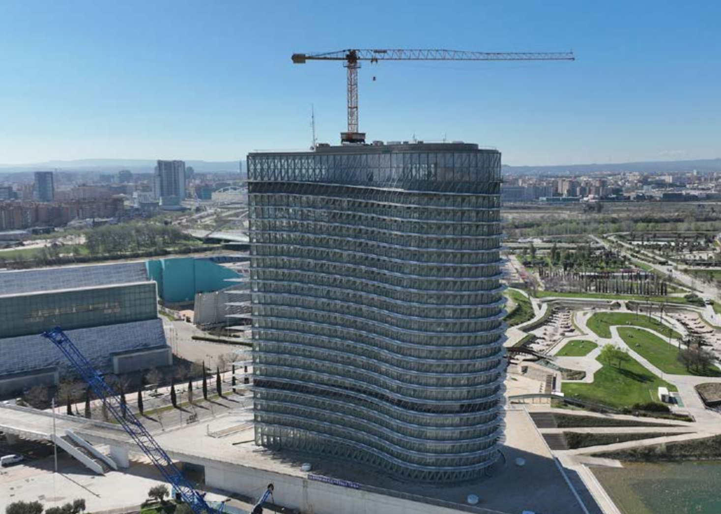
La nueva grúa móvil Liebherr LTM 1650-8.1 de grúas El Portillo se estrenó con el montaje de la grúa torre Liebherr 110 EC-B.
