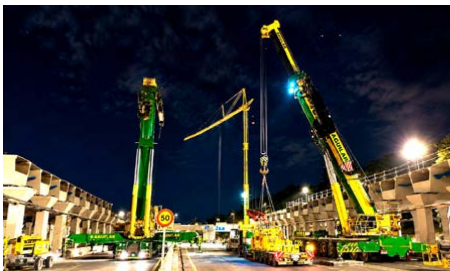
Grúas Aguilar participa en la construcción del nuevo Parque Ventas con siete grúas móviles Liebherr, con capacidades de carga entre 100 y 800 toneladas.
