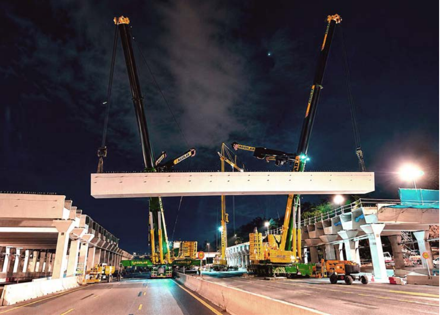
Las grúas móviles Liebherr LTM 1650-8.1 y LTM 1750-9.1 se encargaron del izado y colocación de vigas de hasta 184 toneladas, una de las maniobras más complejas del proyecto.
