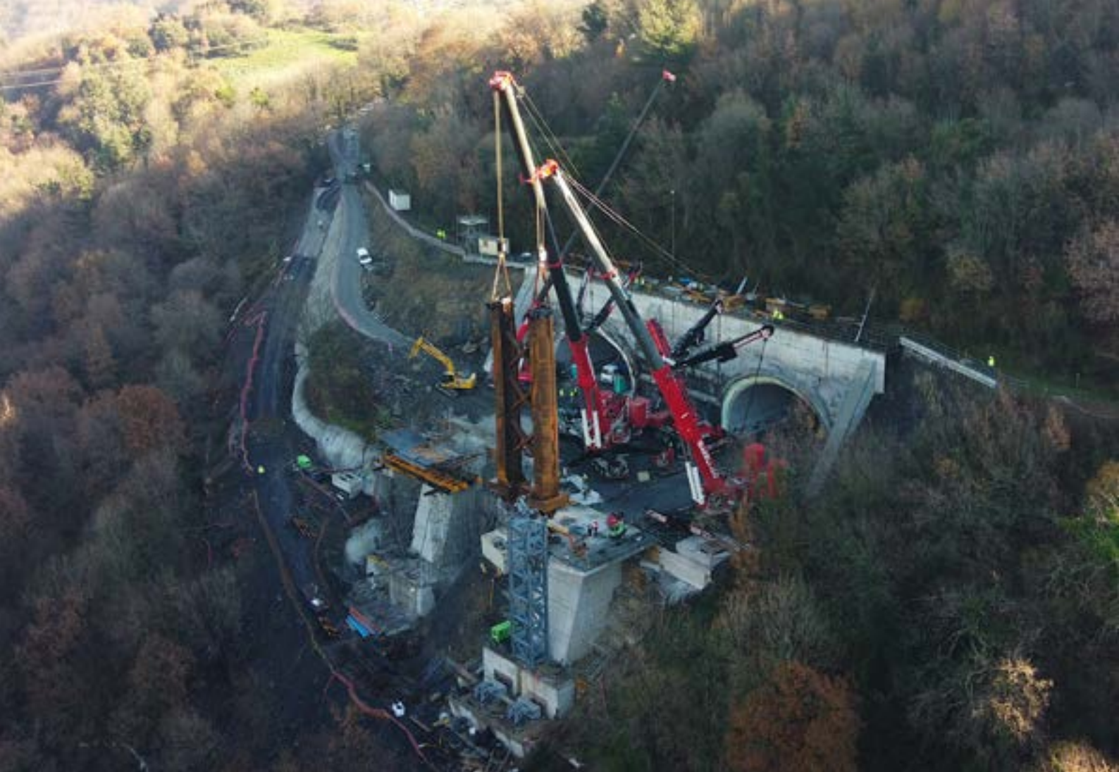
Las grúas móviles Liebherr LTM 1650-8.1 y LTM 1750-9.1 de Grúas Ibarrodo realizan el montaje de dos viaductos en el valle de Bolintxu, en Bilbao
